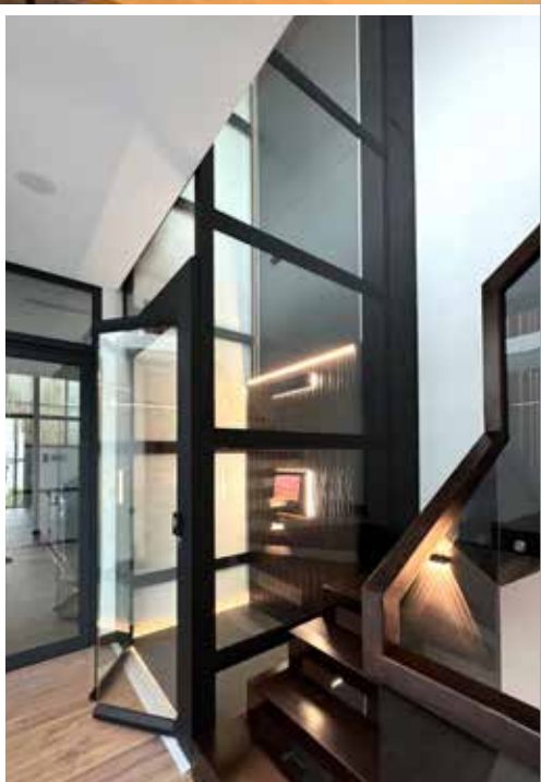
Z85 - Lắp đặt tại Tân Phú, TP.HCM
