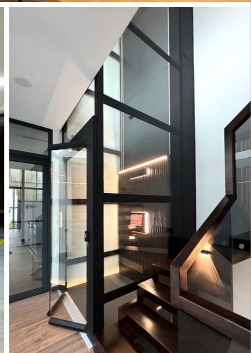
Z85 - Lắp đặt tại Tân Phú, TP.HCM
